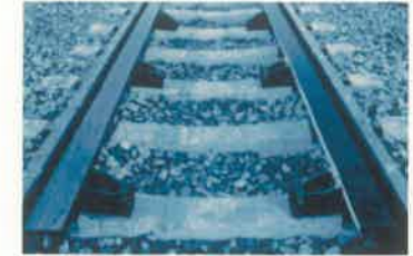
脱線防止ガード Derailment prevention guards
