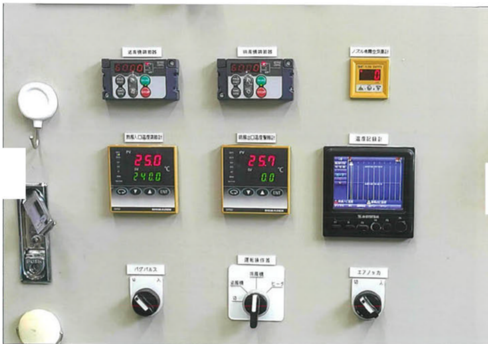
運転開始直前の計器盤を撮影。
