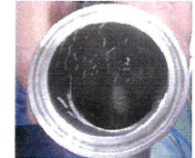
ダクト内部(粉体飛散)
