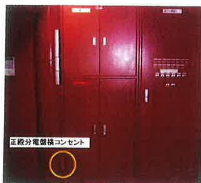
正殿分電盤横コンセント
