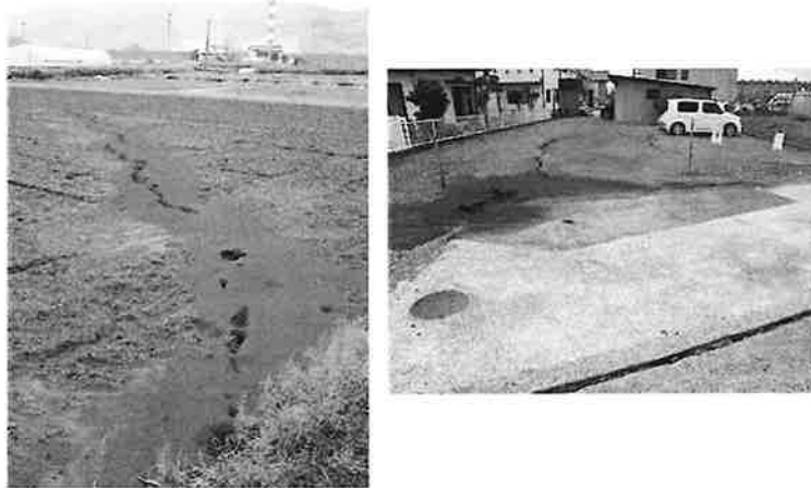
図 22 熊本市西区中原町（左），南区土河原町（右）における噴砂と開口亀裂
