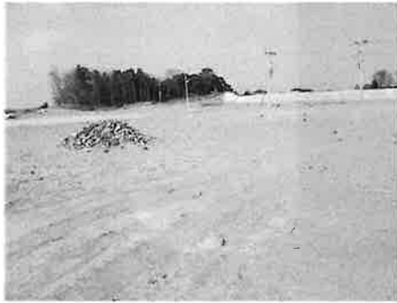
図 15 若宮戸北部溢水発生箇所 ソーラーパネル設置に伴う造成工事による河畔砂丘 消失区間 (2016年3月4日撮影)
