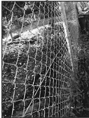
フェンス背面土砂亀裂発生状況 （老人ホーム敷地内）
