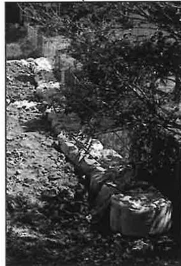
フェンスの歪み発生状況
