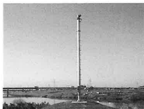
写真 6.1.4 河川監視カメラ
