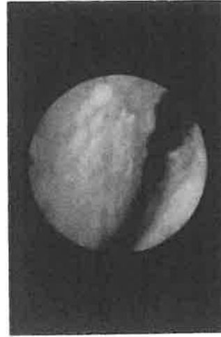
図 7.3.15 ファイバースコープによる底版下の空洞の撮影事例
