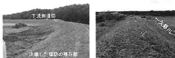
写真2 久慈川左岸 27.0k の決壊状況
