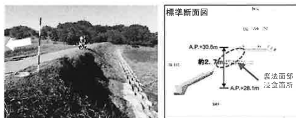
図15 都幾川危機管理型ハード対策の越水後の状況
