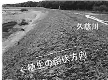
左岸27.0k(決壊箇所下流)
