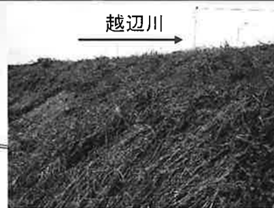
③川裏部の川裏側への植生の倒伏
