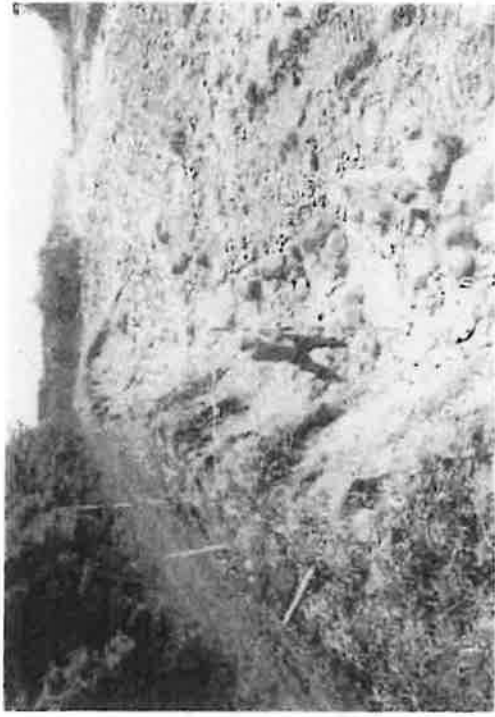
写真3 侵食による堤防被害の事例
