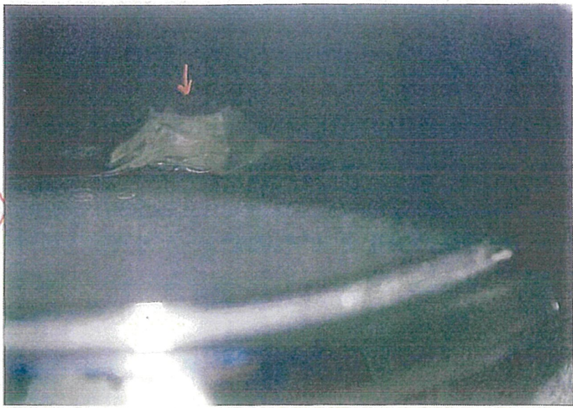
バタフライ弁上に 株式会社KNラボラトリーズ製 超小型ボタンサイズの高温用温度記録計 温度ロガー「スーパーサーモクロン」 設置した状況を撮影
