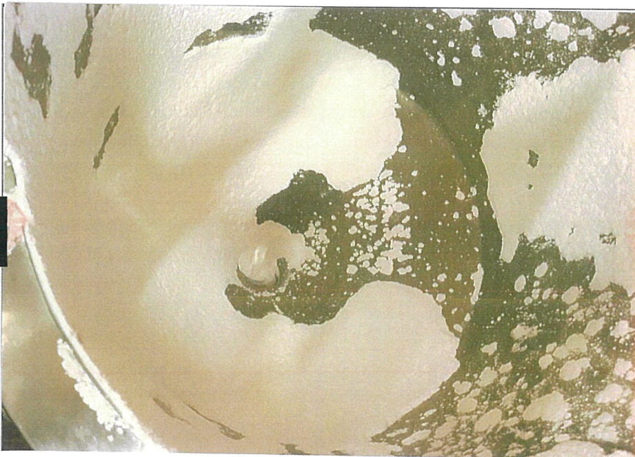
噴霧乾燥直後の乾燥室下部を撮影。
