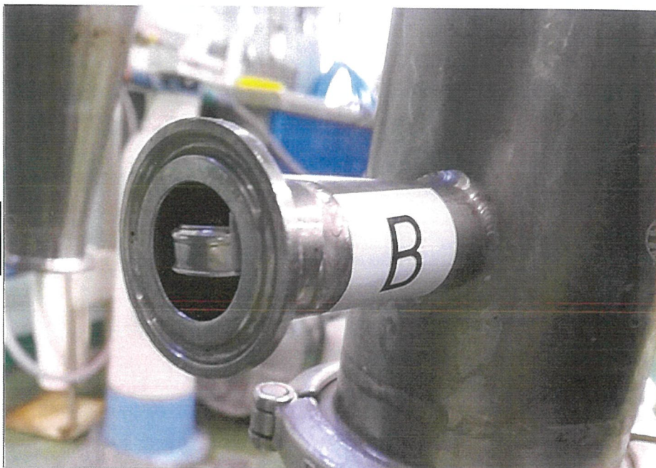
サイクロン入口測定口（測定箇所B）を撮影。
