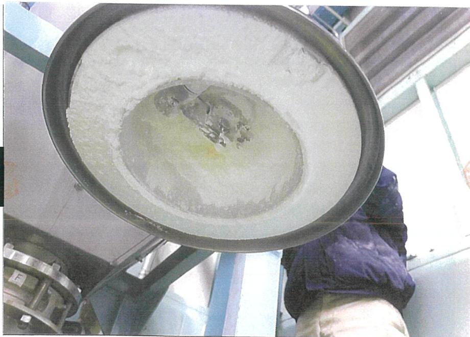
乾熱運転直後のサイクロン下部を裏側から撮影。測定箇所C及びDとも、粉体が覆い被り目視できない状態となっている。
