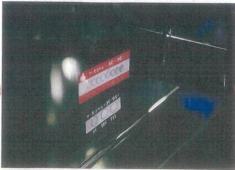
温度測定箇所⑥の「バグフィルタ中間（手前）」に2種類のサーモラベルを貼付した状況を撮影。
