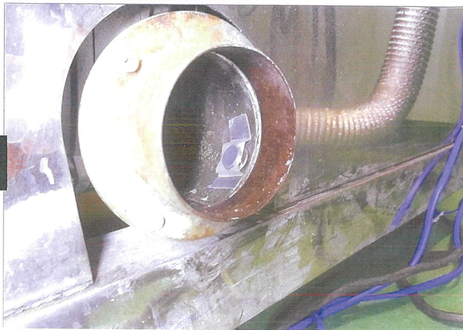
乾熱運転直後の測定箇所 F を撮影。
