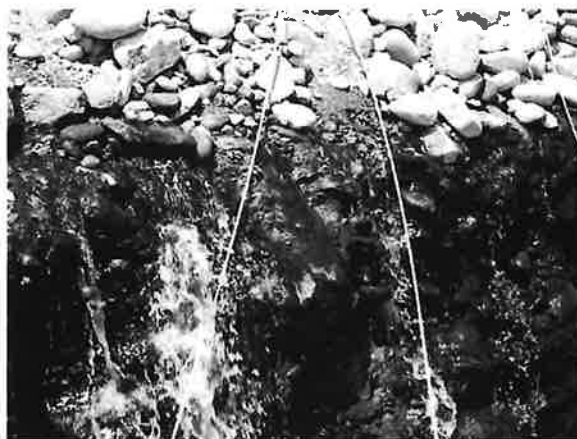
写真 3.3.1 90km 阿久津大橋上流左岸の河床の様子 (護岸工事により洪積層が露出) (2005年5月)
